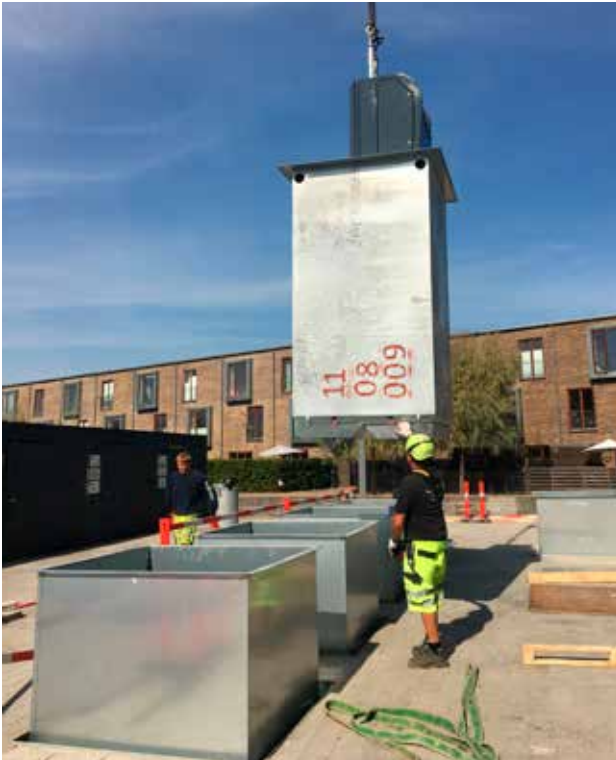
Sikkerhedshegn afspærre containerhullet ved tømning.
